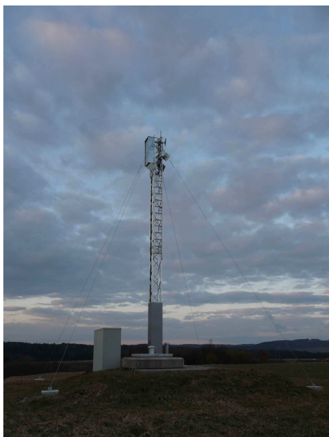
Umsetzungsstation für DSL Versorgung bei Wasserstation zwischen Hausheim und Haslach
